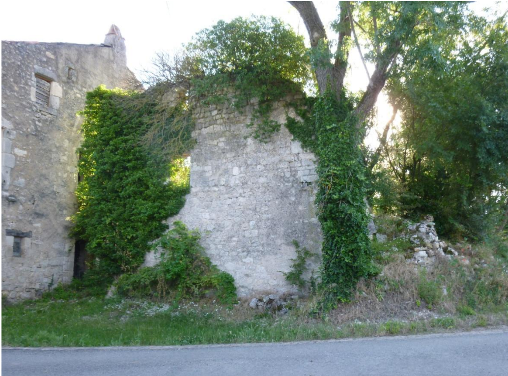
Fig. 38 : Le bâtiment 254 en ruine, au centre.
