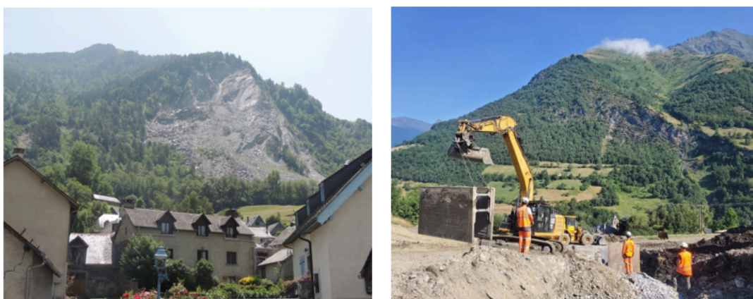
Figure 4 : A gauche : glissement de terrain à Viella (juillet 2020), à droite : travaux de drainage à Viella (juillet 2025).
