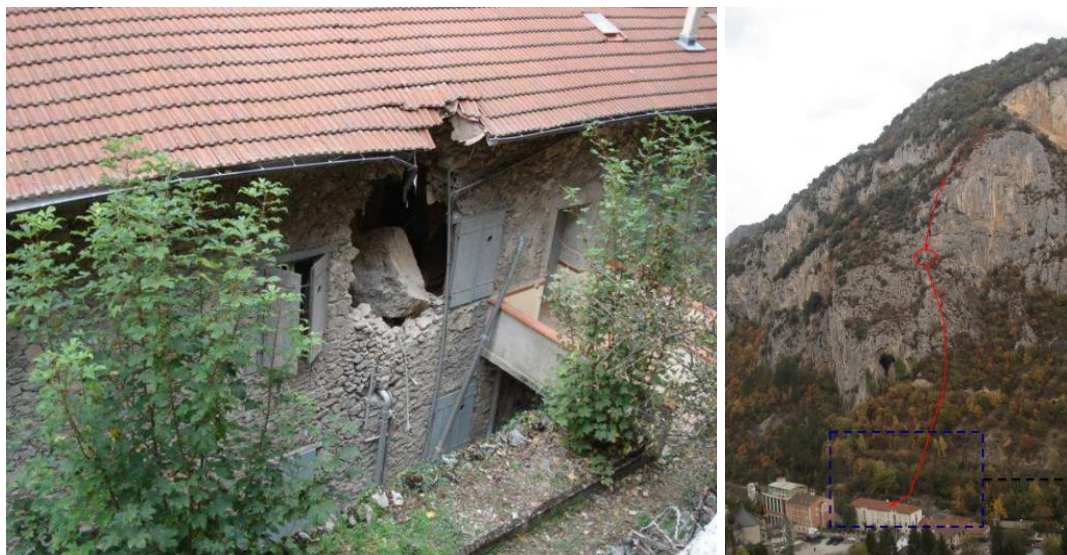
Figure 58 : Photographie - Evènement Clot de la Carbonnière 2011, RTM 09/31
