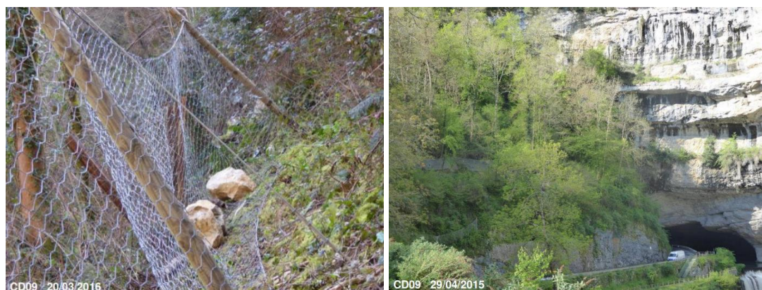
Figure 68 : Photographie - Grotte du Mas-d'Azil protections pare-blocs, CD09
