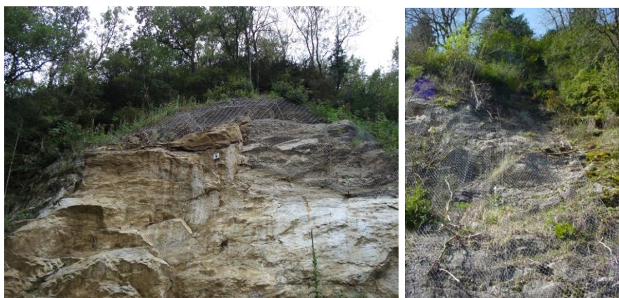
Figure 74 : Photographie - Espinart-Mouline (La) protections pare-blocs, RTM 09/31
