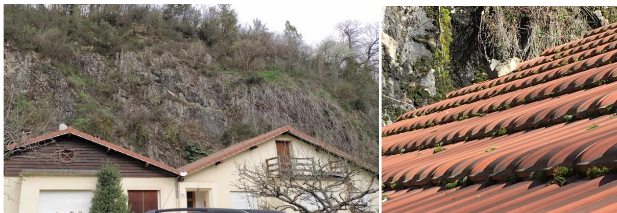
Figure 43 : Photographie - Evènement à Tarascon-sur-Ariège en 2021, RTM 09/31
