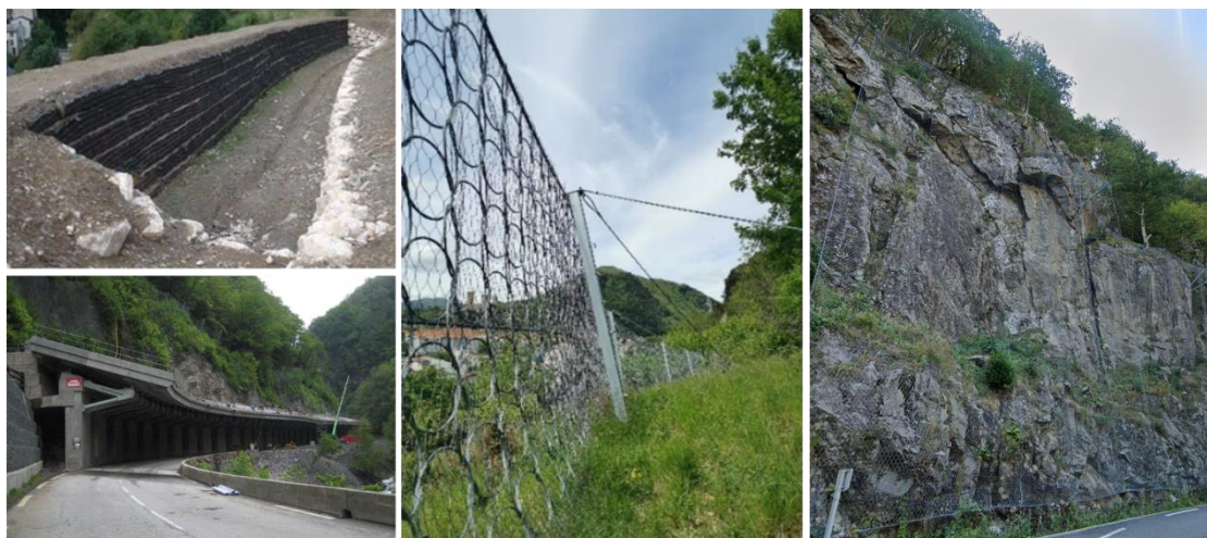
Figure 2 : Photographie - Protections passives pare-blocs, RTM 09/31, Alpes Résines, RAPHOZ-LUQUET I.
