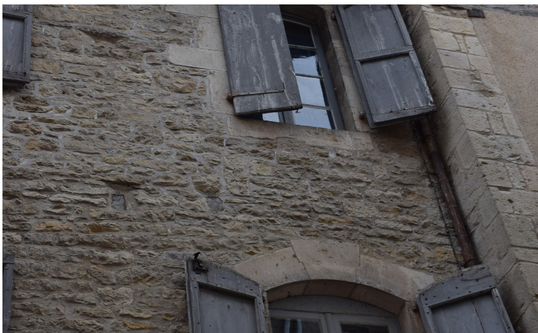
fig. 26 : maison 13 sans chainage d'angle (à gauche) appuyée sur la maison 14 (à droite) (Photographie : Eric Chabanne)
