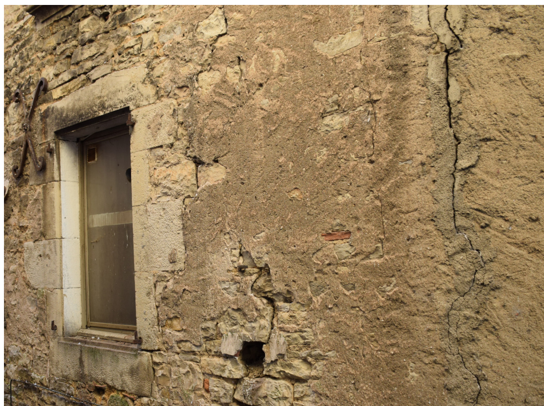
fig. 61 : exemple de fissures dans la façade 5 (Photographie : Eric Chabanne)
