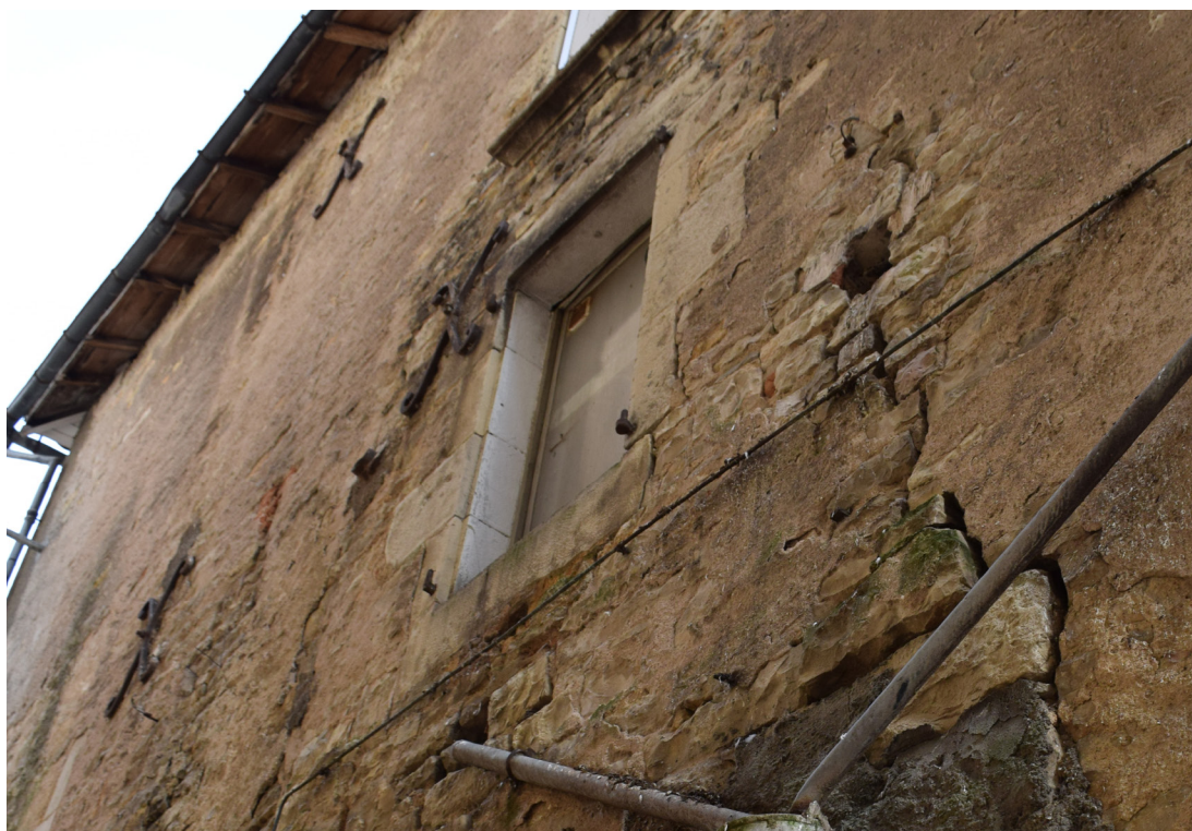
fig. 62 : exemples d'évacuations d'eaux et d'ancrages perturbant la façade 5 (Photographie : Eric Chabanne)
