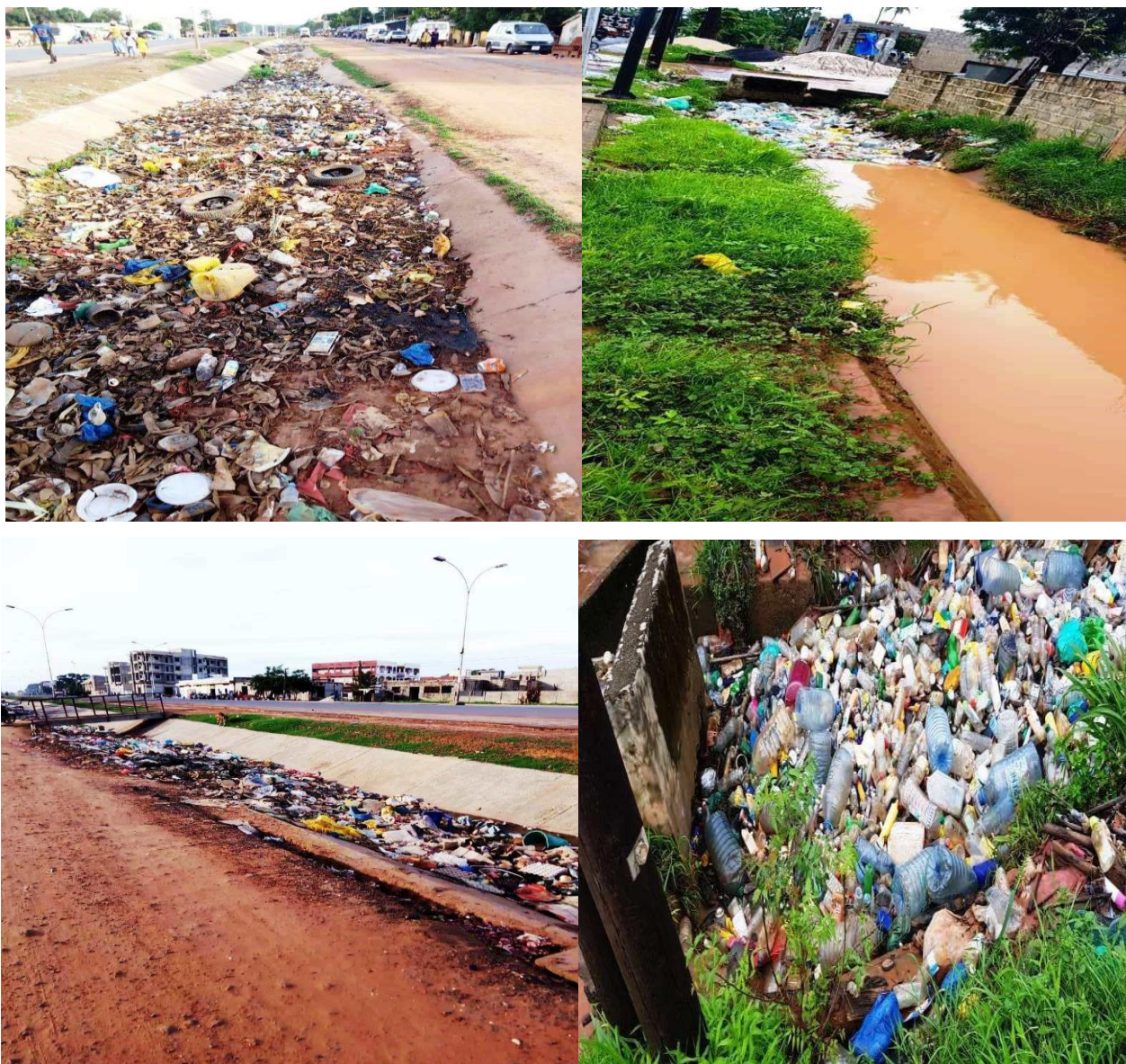
Photo 34: Canaux d'évacuation des eaux usées et pluviales bouchés par les ordures à sur le boulevard 54, Tilène, Corentas et Escale à Ziguinchor
