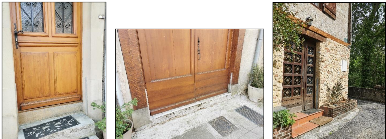
Figure 45 : Batardeaux à Campagne-sur-Arize, 05/05/23, Ilona R-L
