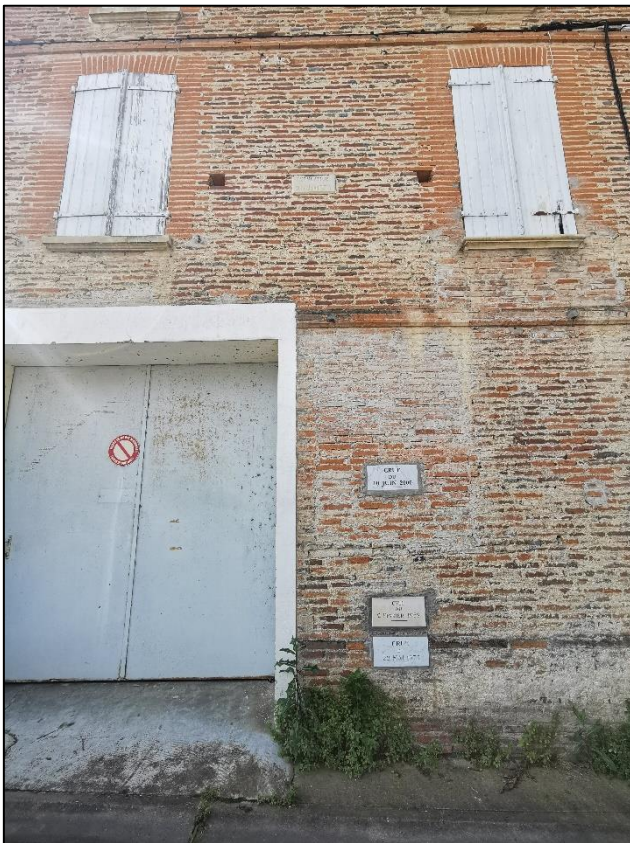
Figure 44 : Repères de crues à Montesquieu-Volvestre, rue de Lisle de la Molle à proximité du parc du Ramier, 31/05/22, Ilona R-L
