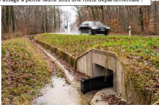
Passage à petite faune sous une route départementale :
