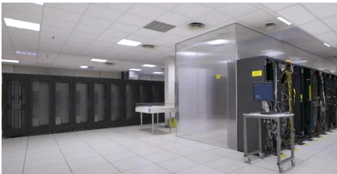
Fig. 8 : Centre de donnée de l'INA à Bry-sur-Marne 249
