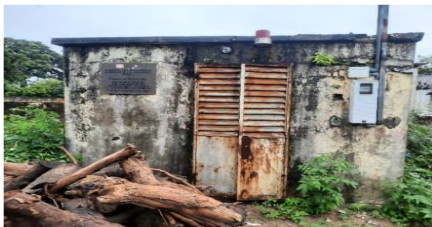
Image 1 : Motopompe alimente la citerne du forage du village de Cabrousse
