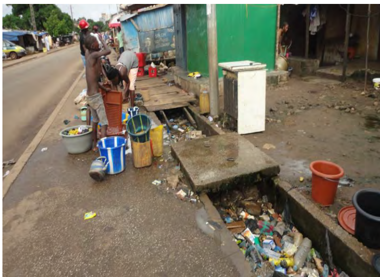
Photo 19: Caniveau mal conçu et engorgé de toutes sortes de déchets à Bonfi
