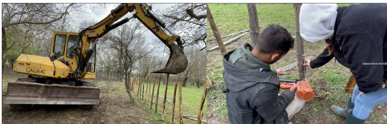
Illustration 22 : réparation des barrages demandant ingéniosité et savoir-faire. Replantation des piquets avec une pelle (à gauche) et agrafage des barbelés (à droite)
