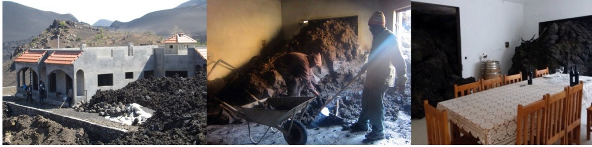
Figure 8.14. Les deux photos à gauche montrent l'édifice construit par David Montrond, en train d'être remis en état (Chouraquí, janvier 2015) ; sur l'image à droite, on voit que les travaux sont achevés; Teresa Nunes, avril 2017).
