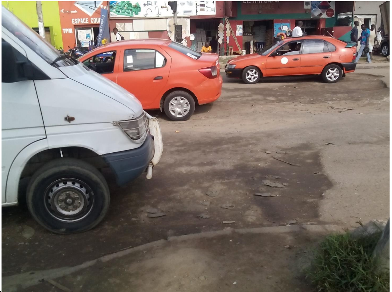
Photo 4 : Voirie endommagée voie express (prise personnelle)
