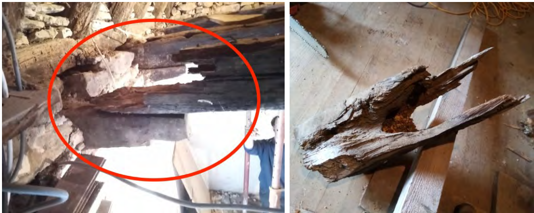
Figure 25 : Poutre dégradée, en place (à gauche) et vue de dessus (à droite)
