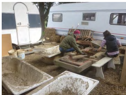
Figure 15 : Baignoires sous le hangar
