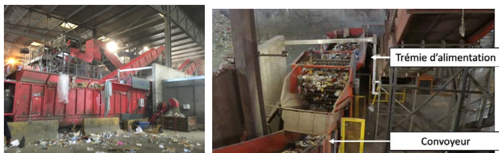
Figure 21. Trémie d'alimentation (CDT B). À gauche, vue du hall ; à droite, vue du process
