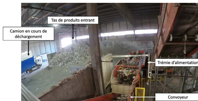
Figure 19. Exemple d'un hall de stockage de la collecte sélective (CDT B)
