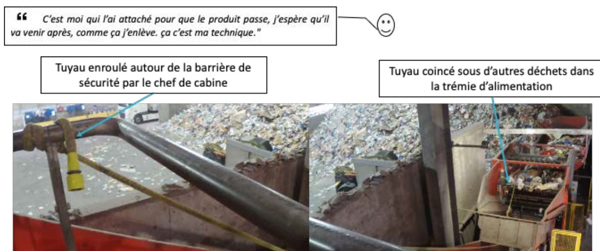
Figure 62. Photographie de la trémie d'alimentation vue depuis le process. Un tuyau a été enroulé de sorte à éviter un bourrage (CDT A)
