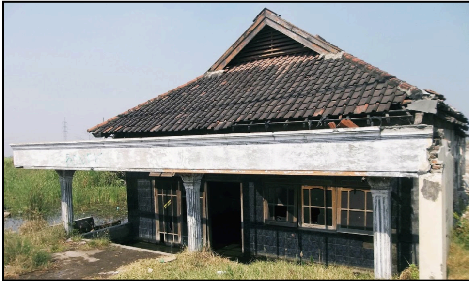
Figure 19 : Maison dégradée et rendue inhabitable par la subsidence de la zone, au sud-est du périmètre endigué contre les flots de boue © Cahill Kece, 2019
