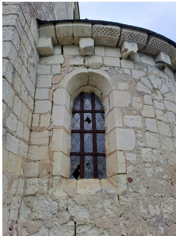
[Figure. 76] Fenêtre sud du chœur de l'église Saint-Maurice à Chartrené, Maine-et-Loire.
