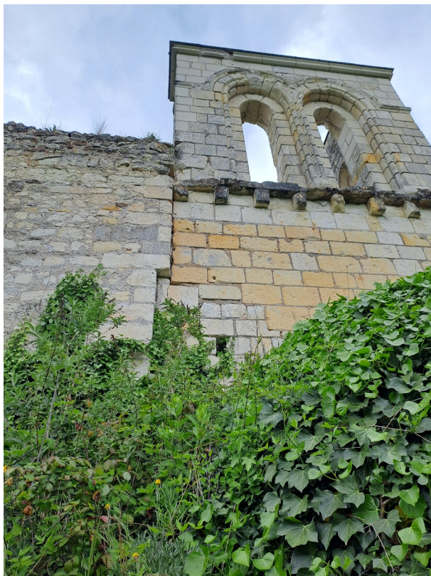
[Figure. 68] Jonction extérieure entre les maçonnerie du pignon oriental du clocher de l'église Saint-Maxenceul à Cunault.
