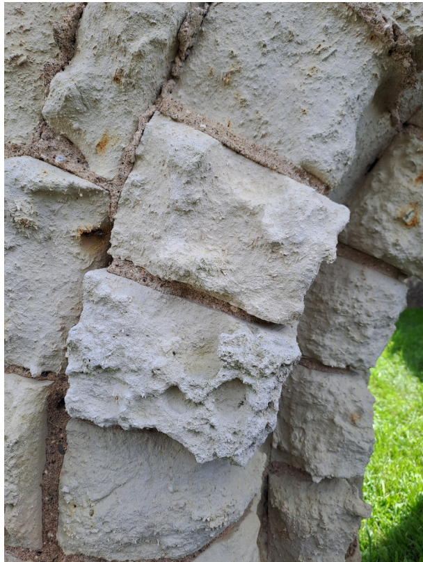
[Figure. 81] Détail du portail occidental de l'église Saint-Maxenceul à Cunault, état actuel.
