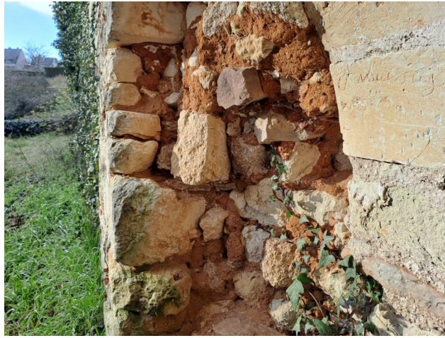
[Figure. 16] Détail de l'effondrement du parement de la section ouest de la face extérieure du mur méridional de l'église Saint-Maxenceul à Cunault.
