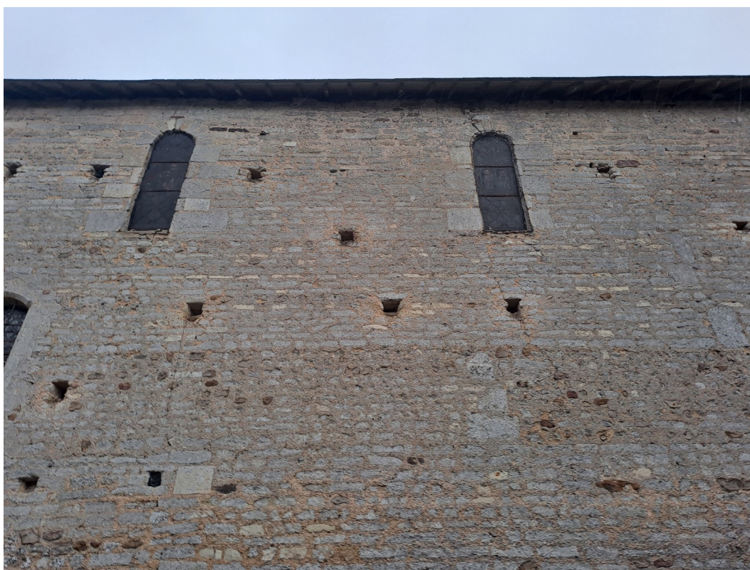
[Figure. 70] Mur gouttereau nord de la nef de l'église Saint-Pierre à Villevêque, Maine-et-Loire.
