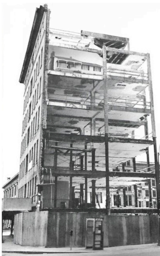
Figure 6-40 - Photographie d'un immeuble existant, partiellement démoli, laissant apparaître son ossature porteuse. Sur le dernier niveau, un collage a été réalisé, incluant une maison indépendante sur le plateau nu de la structure. Ce document montre d'utilisation d'une GSA pour mettre en œuvre le scénario du Highrise of Homes . Source : SITE, 1982, Highrise of Homes , Rizzoli, New York, p. 103
