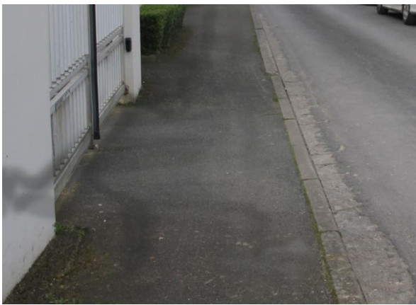
Asphalte sans végétation
