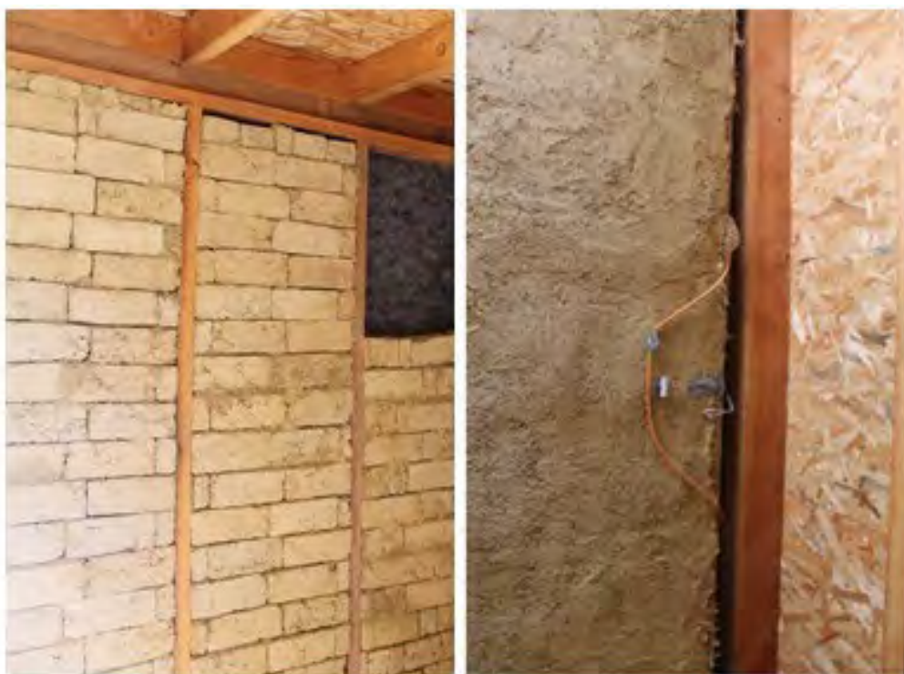
Photo 96 : Système de climatisation passive (photo 1 : cloison de briques de terre crue avant enduit, photo 2 : sonde) (O.R., 2022).
