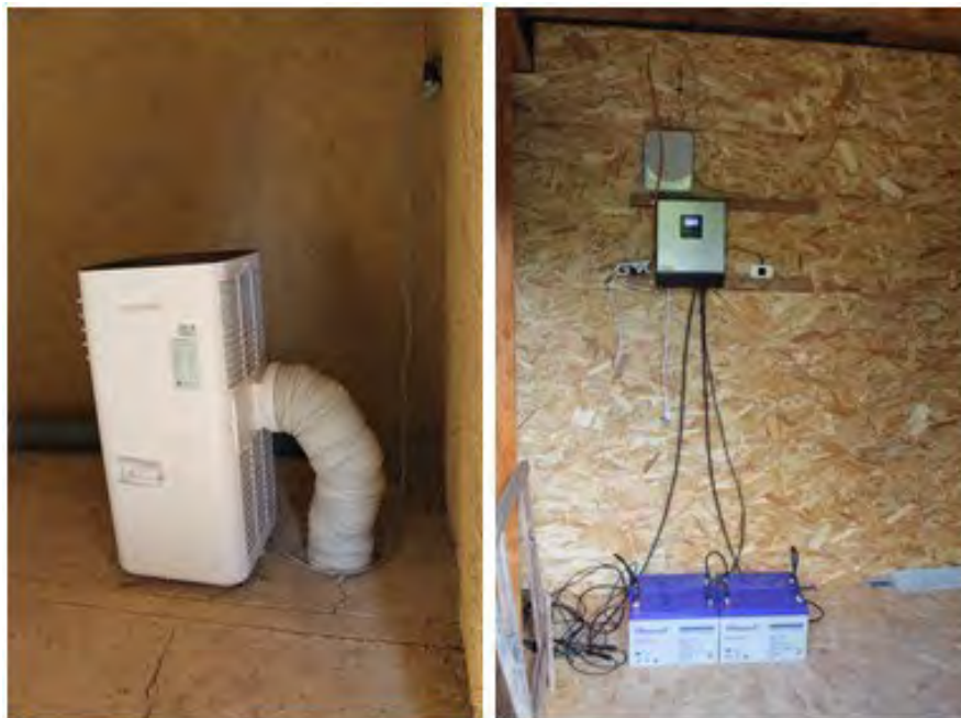
Photo 97 : Système de climatisation active (photo 1 : climatiseur, photo 2 : générateur et batteries raccordés aux panneaux solaires) (O.R. 2022).
