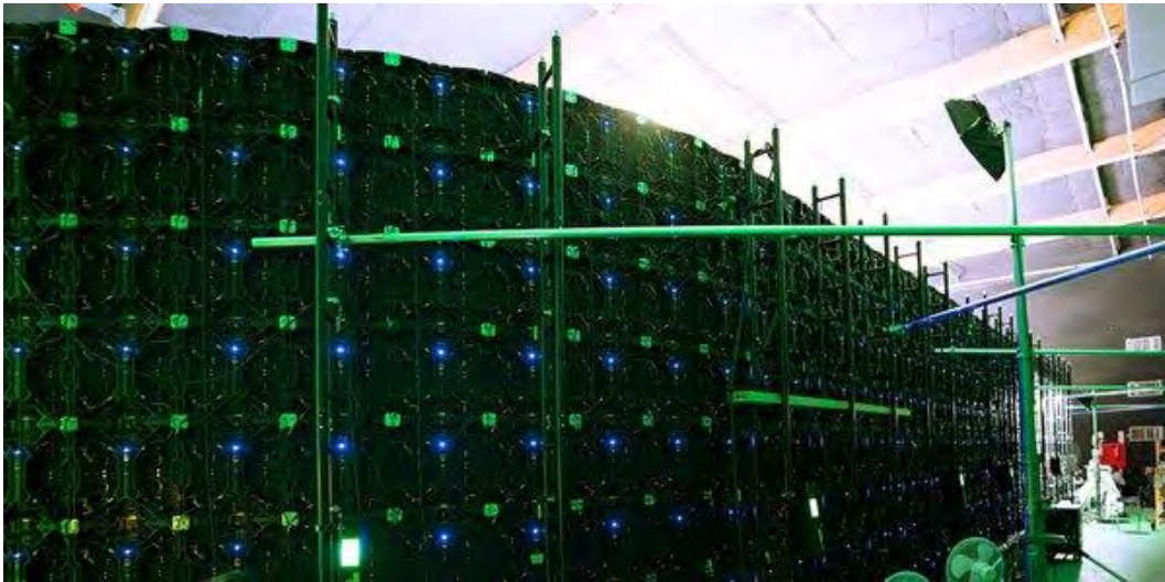
Arrière de la structure d'un mur LED avec l'ensemble des connectiques.
