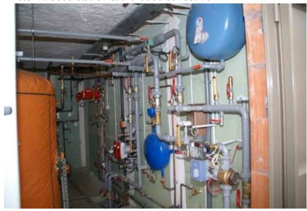
Photo 2 : Sous-station eau chaude collective
