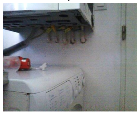
Photo 10 : Chaudière placée dans la cuisine
