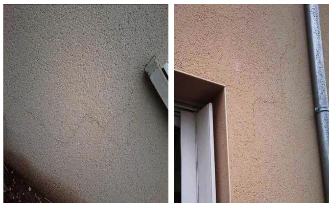
Photo 9 : Fissures sur le mur extérieur
