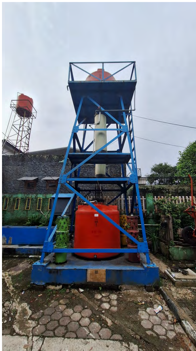
Photographie 6 : Puits artésien à Kopo. Source : auteur (2024).
